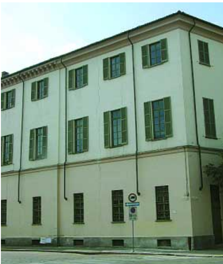
Lesione verticale nella muratura portante causata da un cedimento differenziale di fondazione della porzione di muro a destra della lesione, in corrispondenza di un giunto di costruzione.
