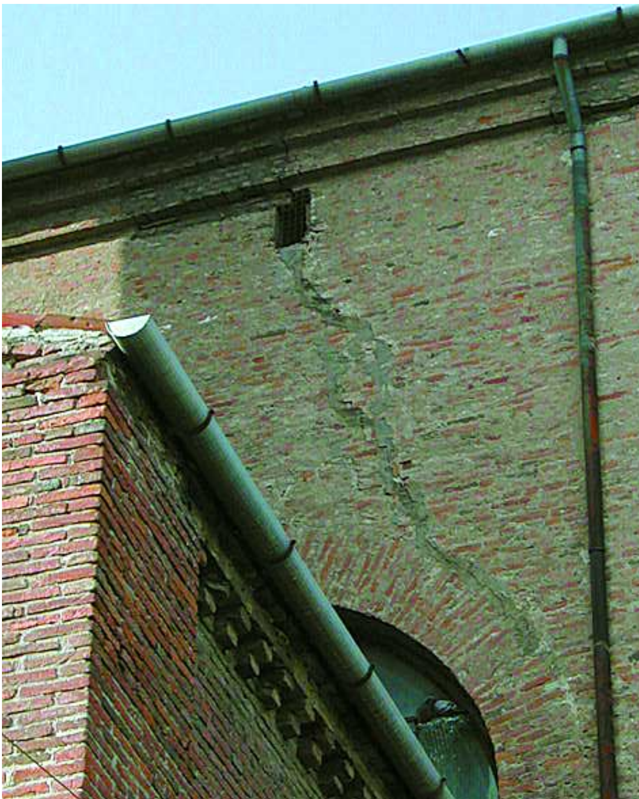
Lesione diagonale in una muratura in mattoni dovuta a spinta del tetto o a eventi sismici.
