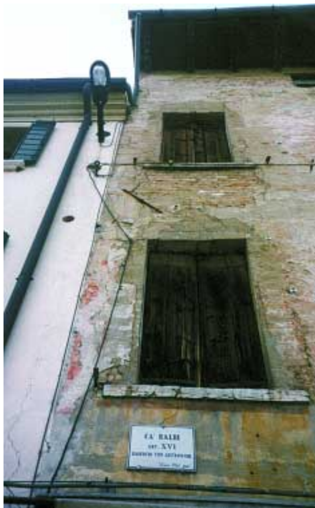
Lesione di architrave monolitico in pietra di una finestra e della muratura soprastante. L'architrave si è scomposto in più "conci" formando di fatto un arco estremamente ribassato e quindi una spinta laterale sulla muratura circostante. Il fenomeno è legato alla realizzazione dell'edificio laterale che ha causato cedimento del terreno.
