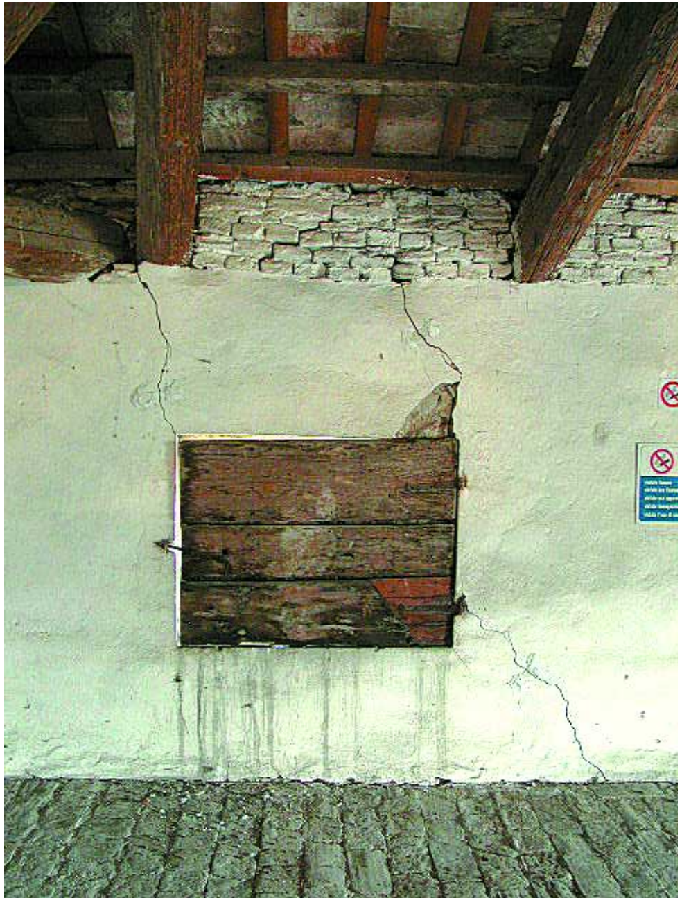
Serie di fessure in muratura portante perimetrale dovute a cedimento delle colonne sottostanti. Le lesioni si sono concentrate in corrispondenza della finestra, che rappresenta una discontinuità della muratura e quindi un punto debole.
