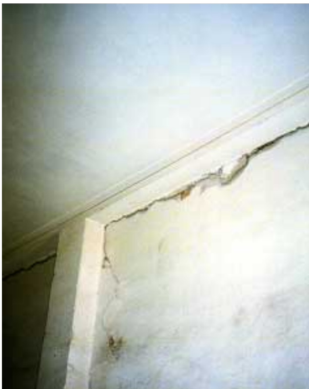
Distacco tra una struttura portante di cemento armato (travi e pilastri) accostata a un tamponamento in laterizio, causato dalla rotazione fondale della nuova struttura rispetto a quella preesistente.
