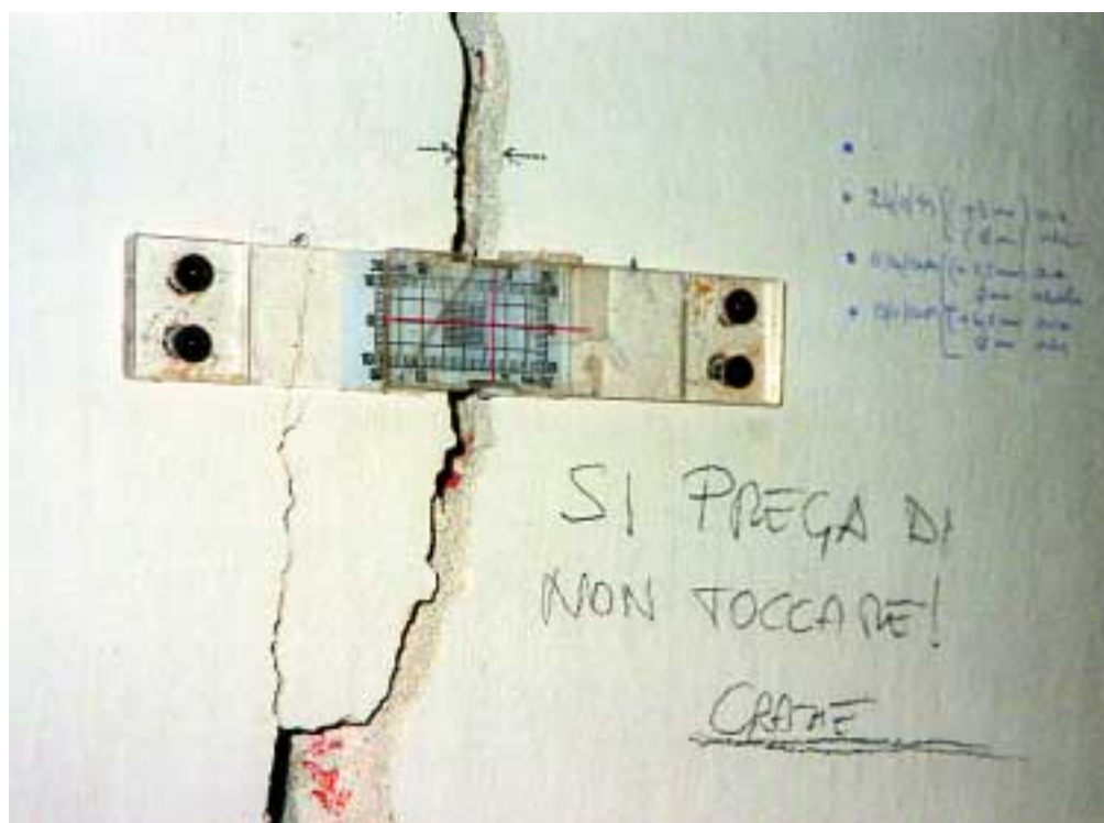
Dettaglio di una fessura di notevole entità con fessurimetro che misura gli spostamenti relativi tra i due lembi di muratura.
