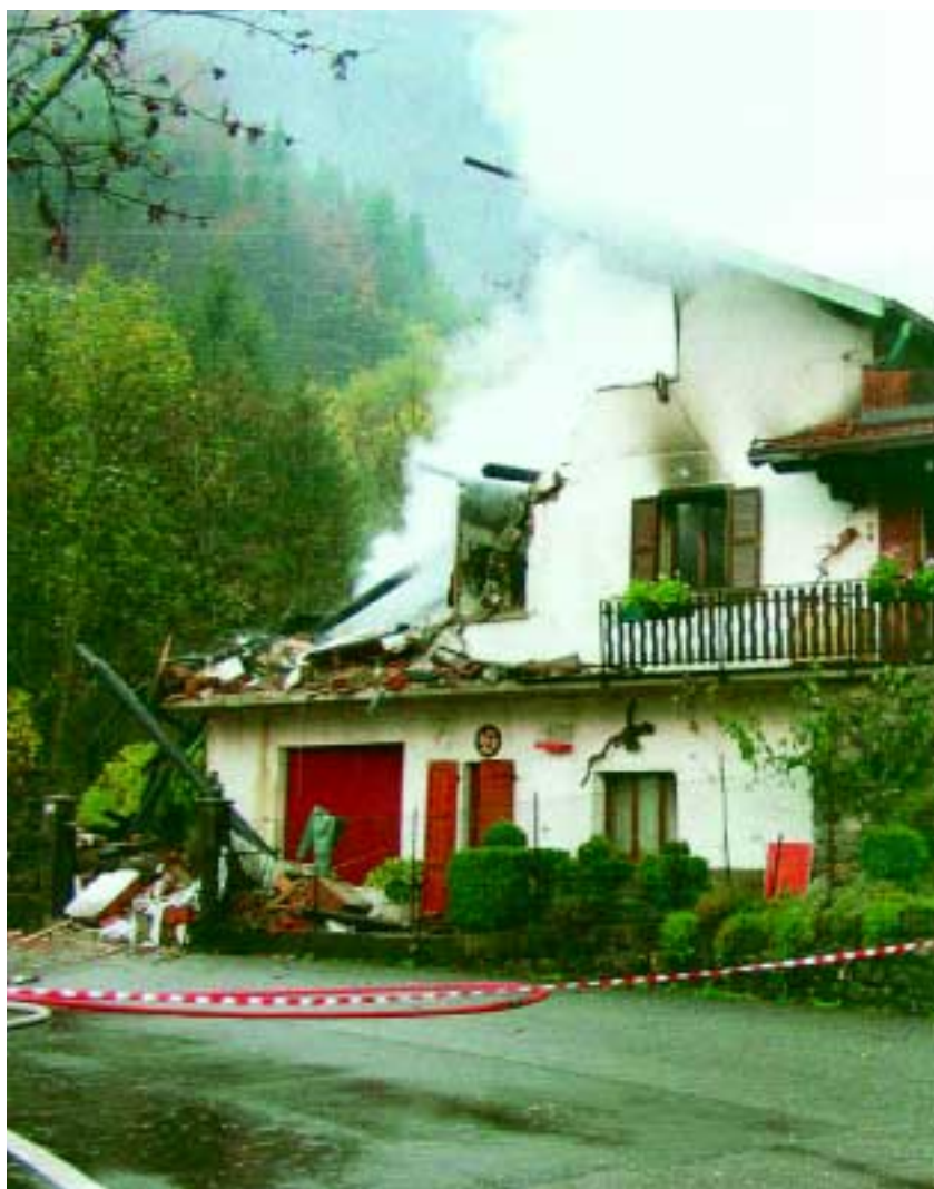
Distruzione di un edificio a seguito dell'esplosione dell'impianto a GPL.
