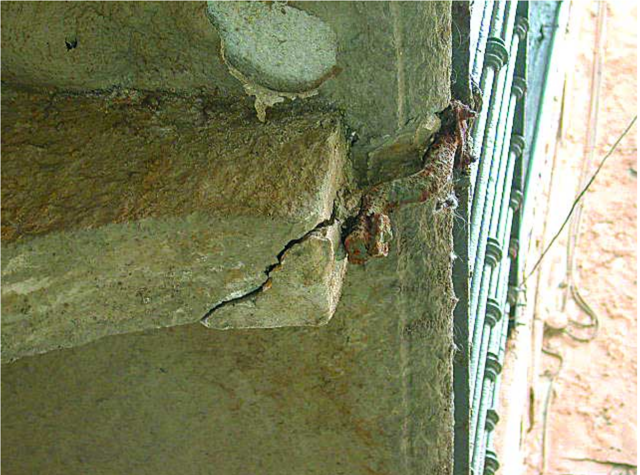
Rottura della mensola di un balcone in pietra dovuta all'ossidazione del supporto in ferro della ringhiera.
